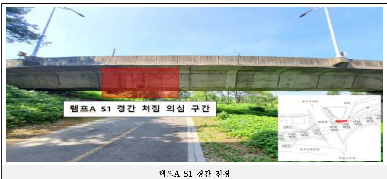
【사진 3.4.26】 램프A 처짐의심구간 S1 경간 전경
